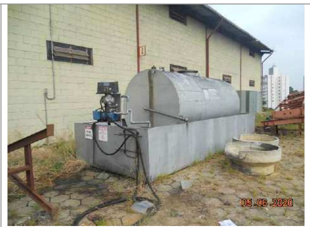
Tanque de Óleo Diesel
