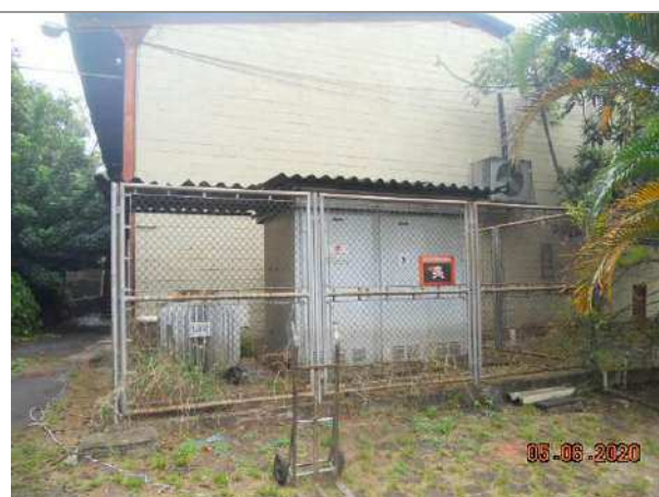
Cabine de energia
