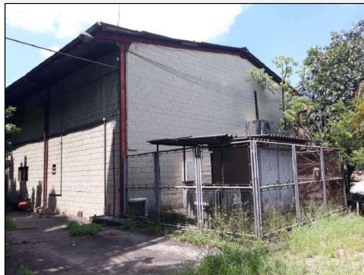
5 FOTO CABINE DE FORÇA
