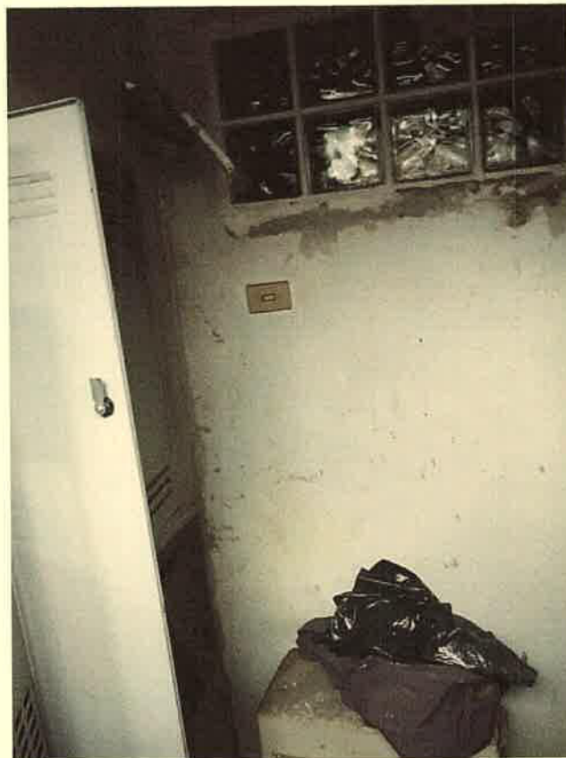
VISTA DA SALA DA CAIXA DE FORÇA.
