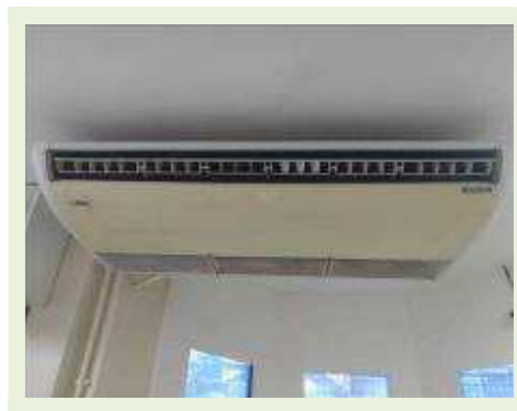
APARELHO DE AR CONDICIONADO TIPO SPLIT MARCA HITACHI CAP. 36.000 BTU | Item: 144 |
