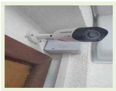
SISTEMA DE VIDEO MONITORAMENTO COM 7 CAMERAS FIXA MARCA ITELBRAS HCTV, 1 GRAVADOR DIGITAL MARCA ITELBRAS 8 CANAIS E INSTALAÇÕES | Item: 140 |
