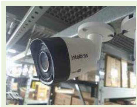
SISTEMA DE VIDEO MONITORAMENTO COM 44 CAMERAS FIXA MARCA ITELBRAS HCTV, 3 GRAVADORES DIGITAL MARCA ITELBRAS MULTI HD 16 POSIÇÕES E INSTALAÇÕES | Item: 16 |
